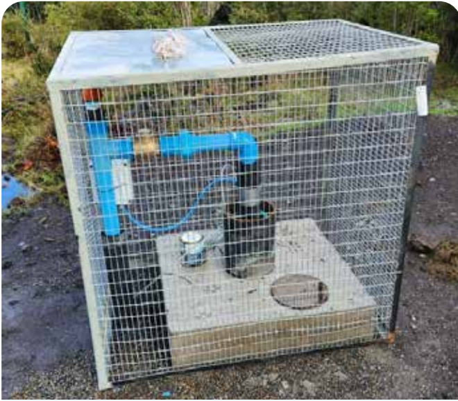
Pozo de Extracción y Bomba de Pozo.
