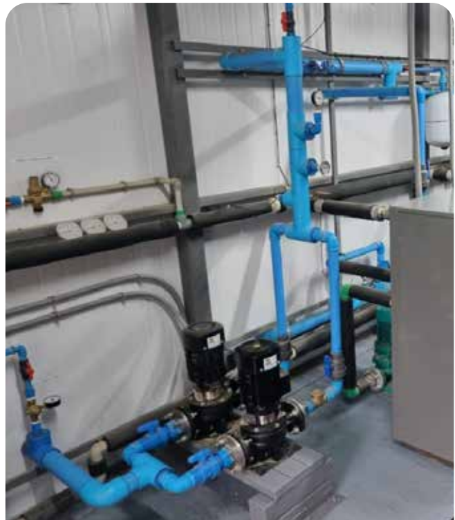
Bombas de sistema de loops subterráneos.
