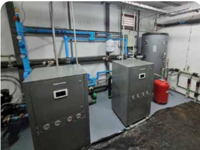
Bombas de calor y estanque de inercia.
