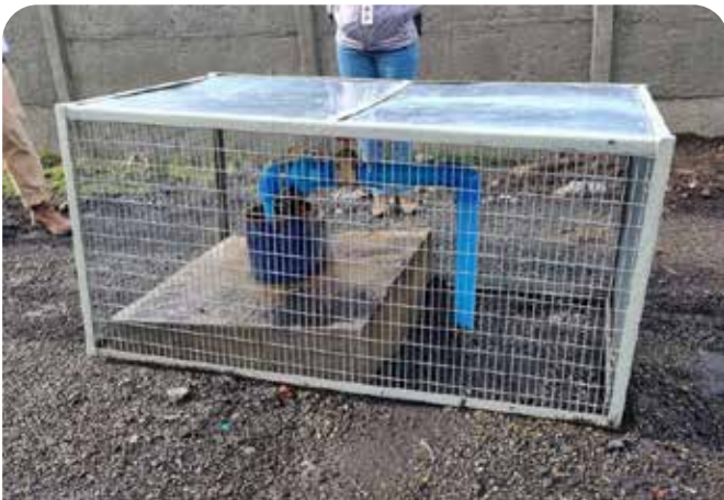
Pozos de Inyección.
