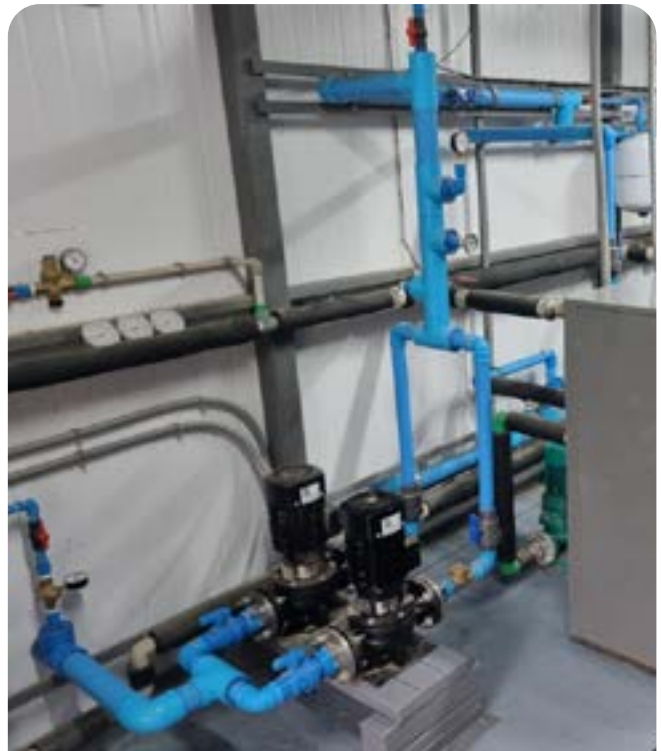
Bombas de sistema de loops subterráneos.
