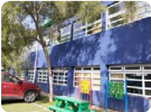
Juntas entre muro y pilar.
