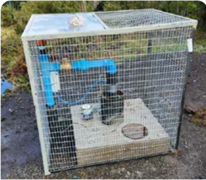
Pozo de Extracción y Bomba de Pozo.
