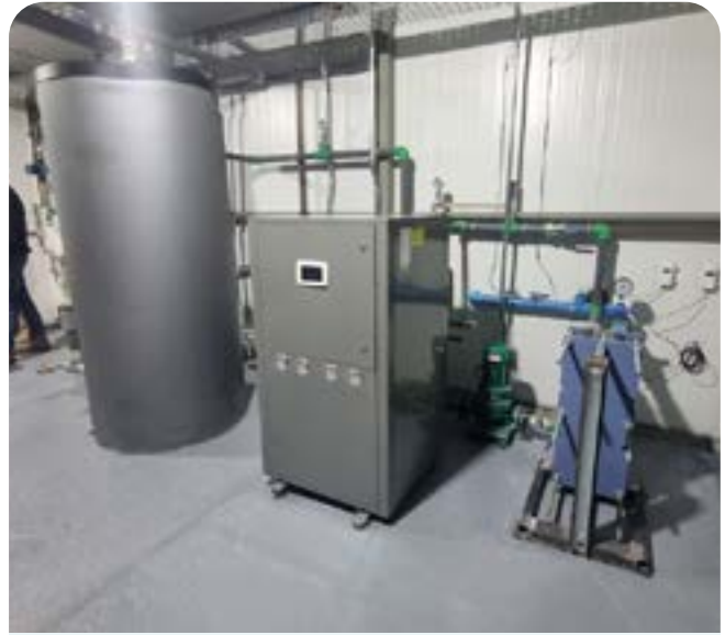
Estanque de inercia, bomba de calor e intercambiador de calor.
