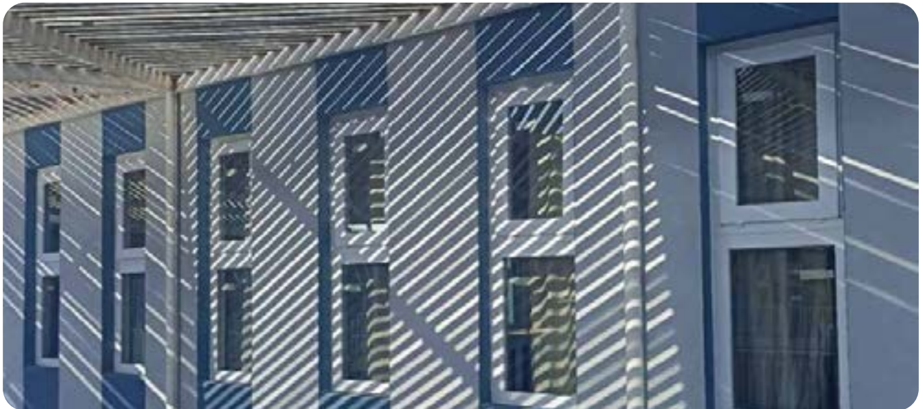
Nuevas ventanas de doble vidrio hermético con marcos de PVC. Se aprecia la sombra tamizada de los sombreaderos.
