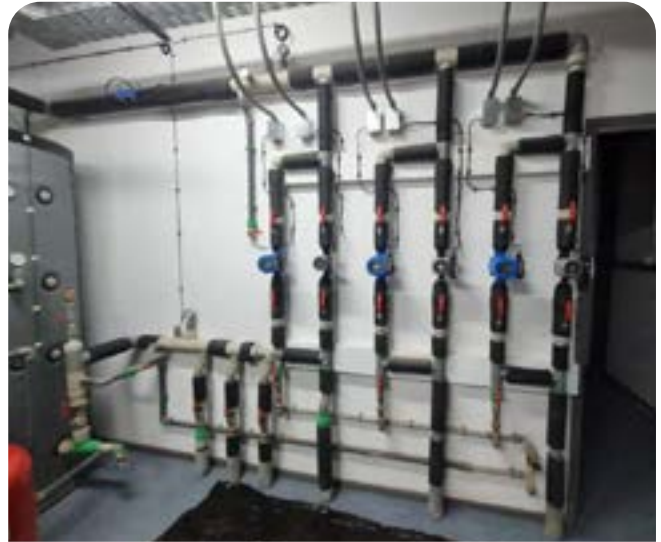
Bombas de distribución Acumulador de Inercia - Zonas de Calefacción.
