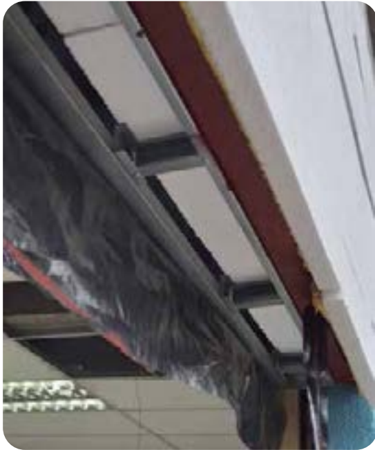
Sobre estructura en acero galvanizado encuentro muro-losa del 2º piso con viga de 1º piso.
