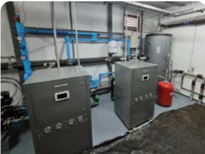
Bombas de calor y estanque de inercia.
