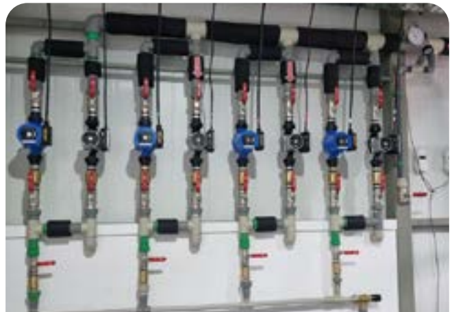
Bombas de distribución Acumulador de Inercia - Zonas de Calefacción.
