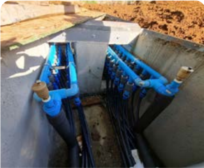
Colector Loops Subterráneos
